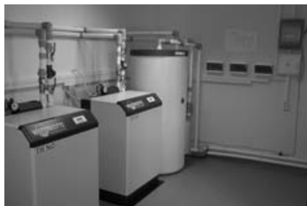
Современный тепловой пункт
