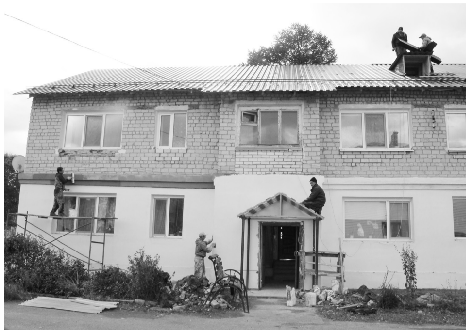
Строительная бригада работает на объекте. Завершается отделка фасада, покрытие крыши и входных групп.
