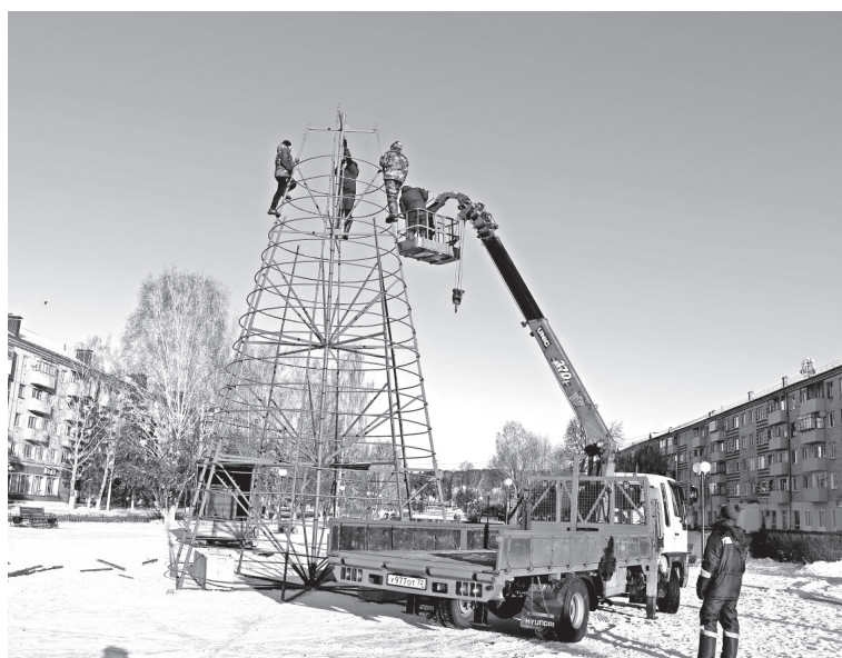
• В минувшую субботу на центральной площади Заводоуковска рабочие ООО «БРИСС» приступили к установке новогодней ели. За день специалисты успели смонтировать каркас и «одеть» дерево пушистой хвоей.
