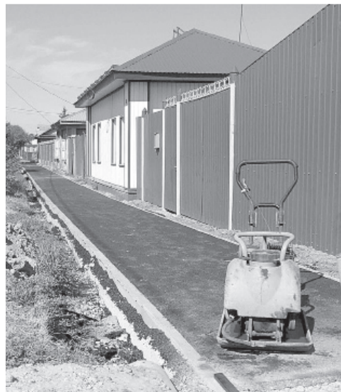
Кипят сезонные работы на городских улицах, Ишим становится ещё уютнее, красивее и комфортнее. // Фото Василия БАРАНОВА.
