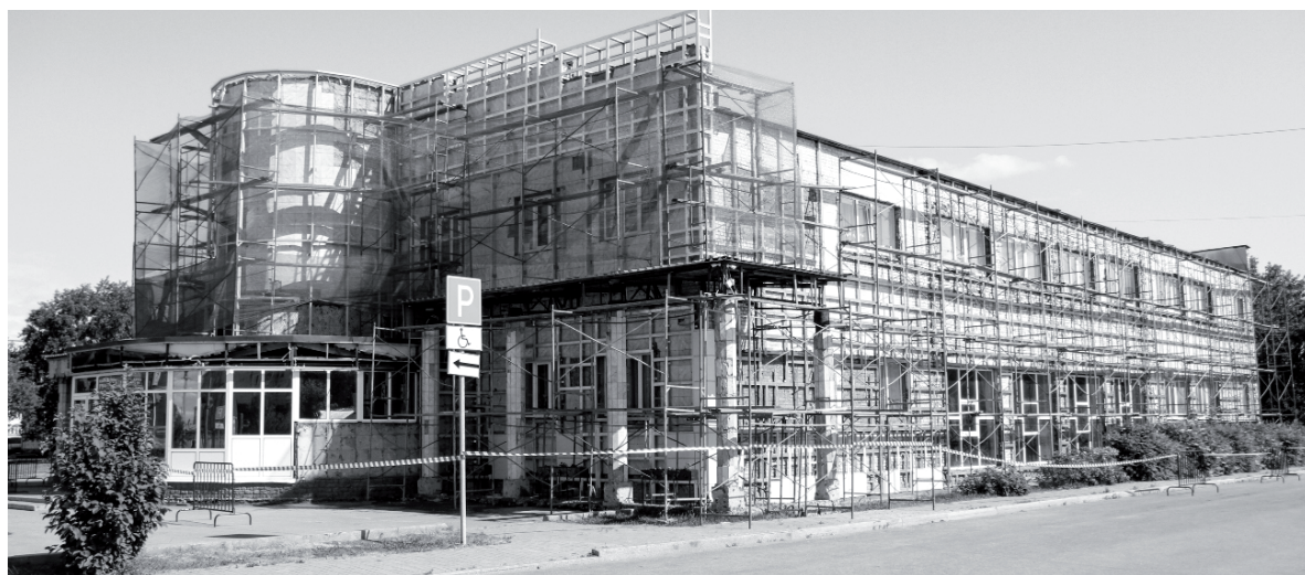
Сейчас строители монтируют металлокассеты сливочного оттенка на боковых и задней стенах здания Дома культуры, а центральный фронтон и входную группу украсят чёрные витражи. // Фото Василия БАРАНОВА.
