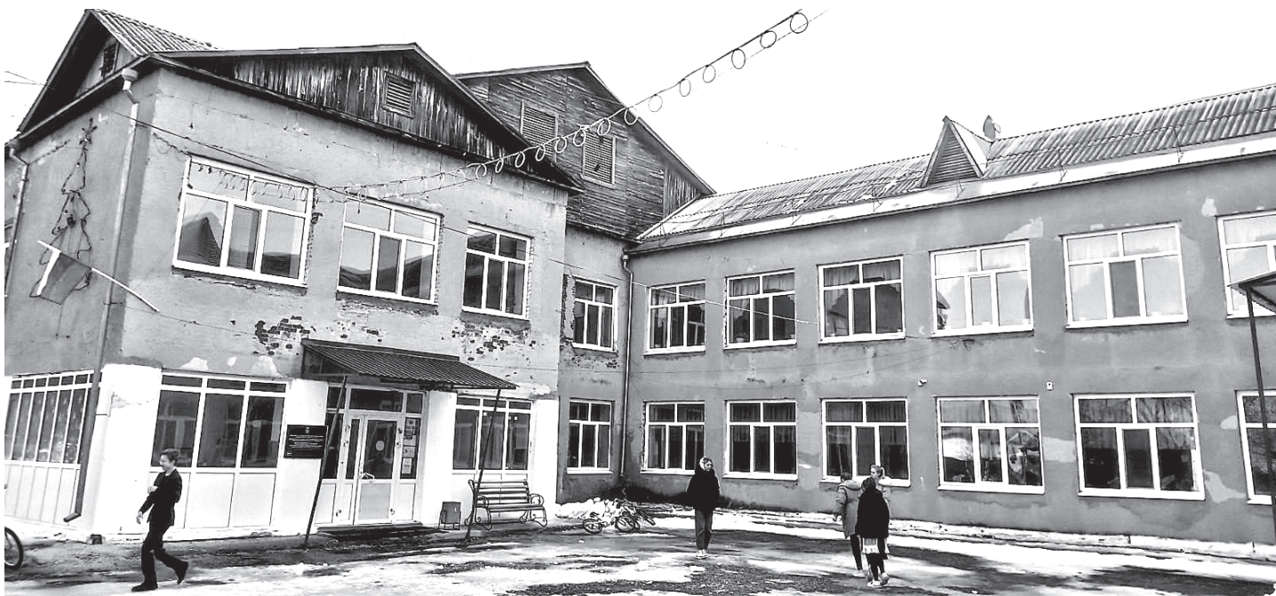
• Жители села Колесникова обратились к депутатам с просьбой обследовать здание школы, чтобы понять, почему уходит тепло. Школе без малого полвека. Капитальный ремонт здесь прошёл в 2010 году. Однако в некоторых учебных кабинетах в отопительный сезон всё равно бывает прохладно.
