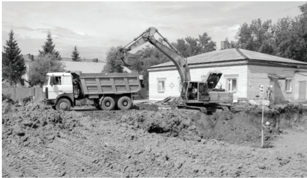
В настоящее время завершаются земляные работы по устройству котлована. Вскоре строители перейдут к закладке фундамента. // Фото Василия БАРАНОВА.
